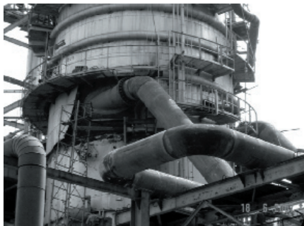
Obr.7 Vakuová destilace ropy – Instalace transferového potrubí DN1100 mm z pece do vakuové kolony, BRC Sýrie
