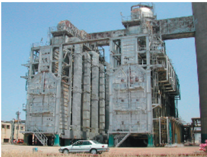
Obr.4 Atmosférická destilace ropy – trubkové pece, BRC Sýrie
