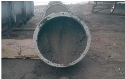
Obrázek 3 Ucpané potrubí na přesypu PD 156→PD 157 na straně výduchu
