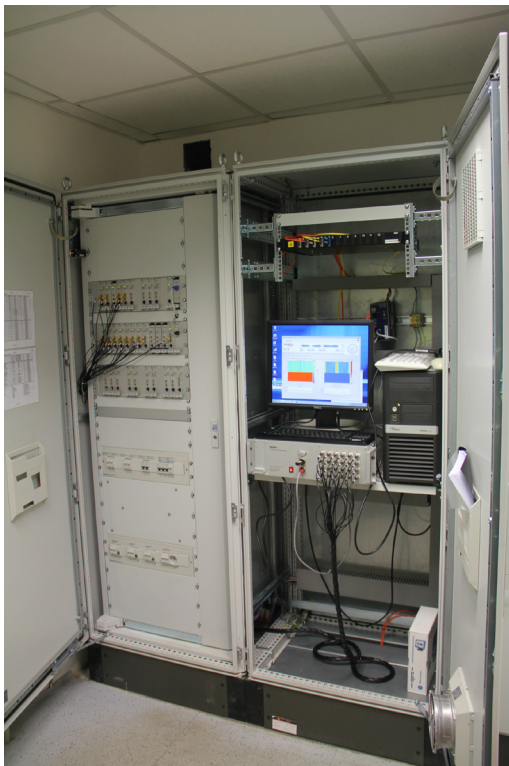
Obr. 2: Instalace analyzátoru na elektrárně
